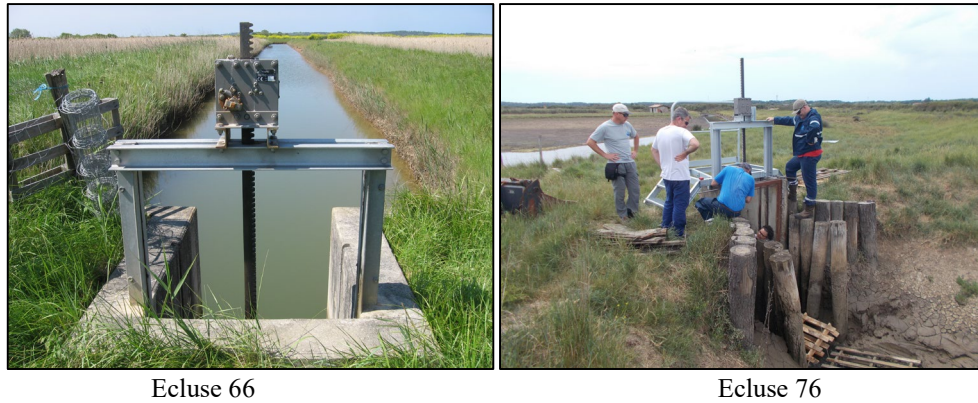
Figure 4 : Les deux prises d'eau principales de l'exploitation
