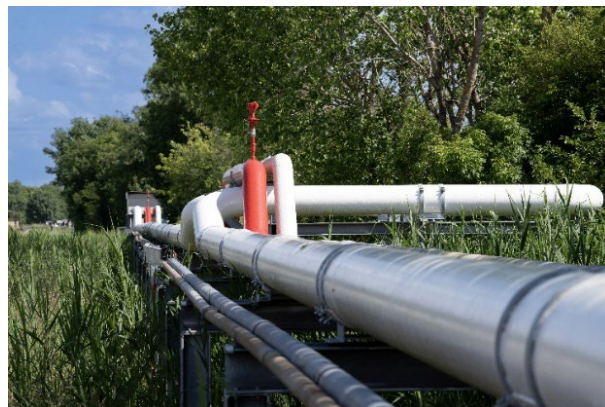
Figure 5: Canalisation à Ambès
